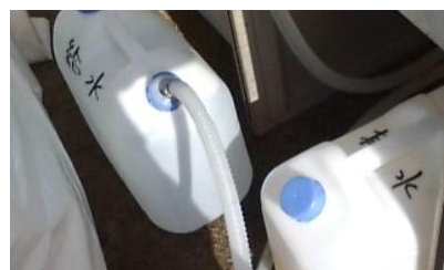
シンク内に設置してあるタンク
